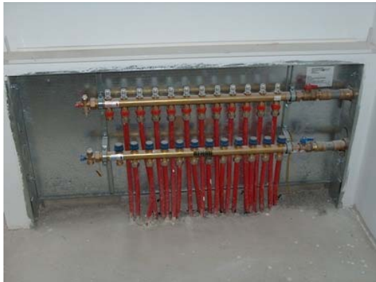
Razdelilnik za ogrevanje in hlajenje v jedru betona
